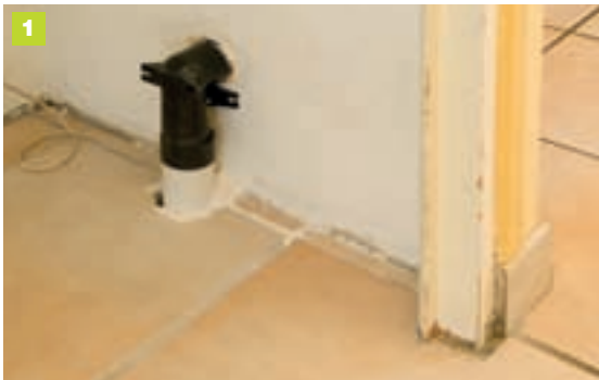
Remontée en placard
